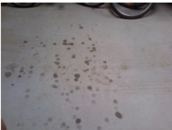
Traces au sol de la chute des condensats
