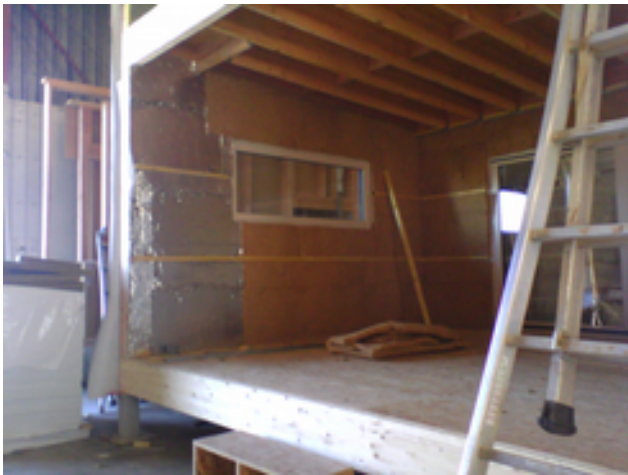
Vu intérieur d'un caisson et de sa sur-isolation, laine bois en remplissage des rails de Fermacell, sur caisson ouate.
